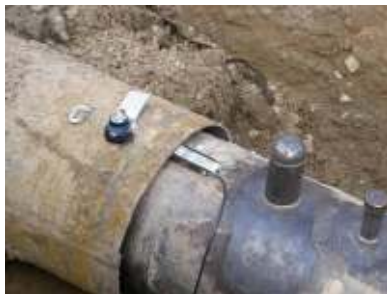
Mini Camera Entering the Casing
